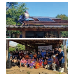
太陽光発電設備の寄贈 (ランブーン新電元)
