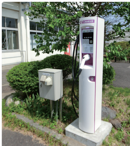
新電元工業に設置されたEV車用普通充電器
