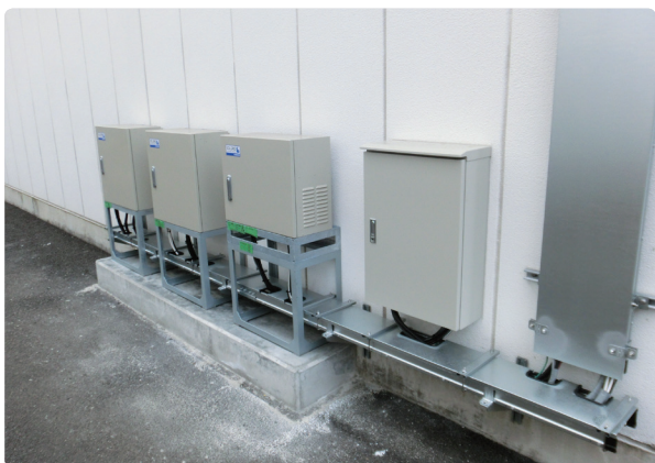
新電元工業に設置された太陽光発電システム (当社製パワーコンディショナ)
