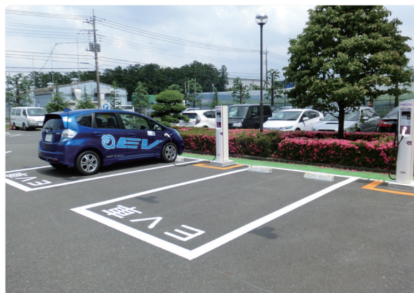
新電元スリーイーに設置されたEV車用普通充電器
