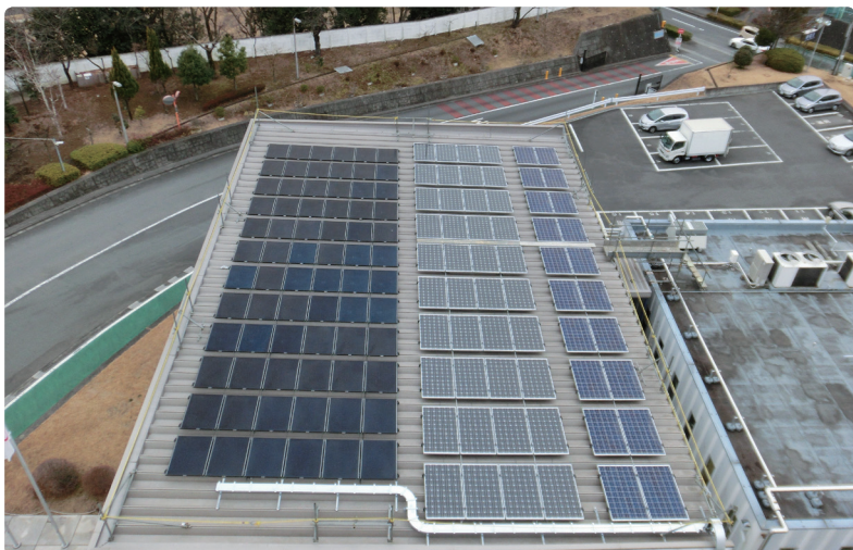
新電元工業に設置された太陽光発電システム
