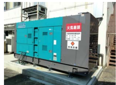
追加導入した非常用発電機 (新電元工業飯能工場)
