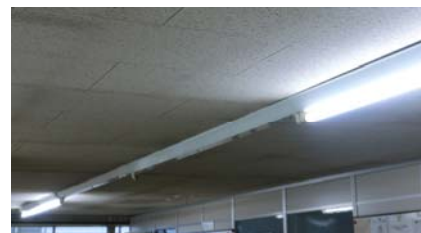
節電対策後の照明
