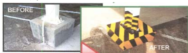
危険箇所の改善例
