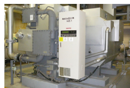
既存設備（重油式）
