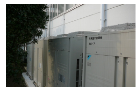
新設備（電気式）
