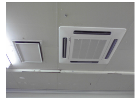
新空調設備（電気式）
