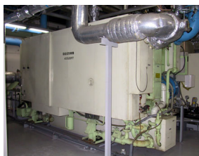
ガス焼き吸収式冷凍機
