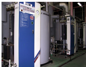
小型貫流ボイラー
