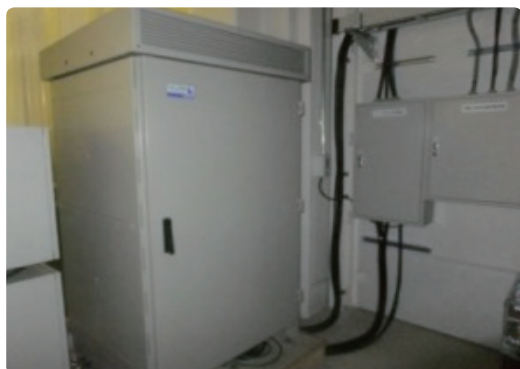
パワーコンディショナー接続による電力回生
